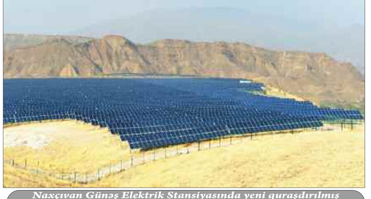
Naxçıvan Günəş Elektrik Stansiyasında yeni quraşdırılmış 2 meqavat gücündə günəş panelləri
